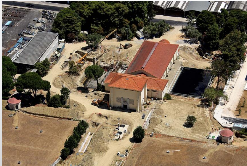
Estação Elevatória dos Olivais
